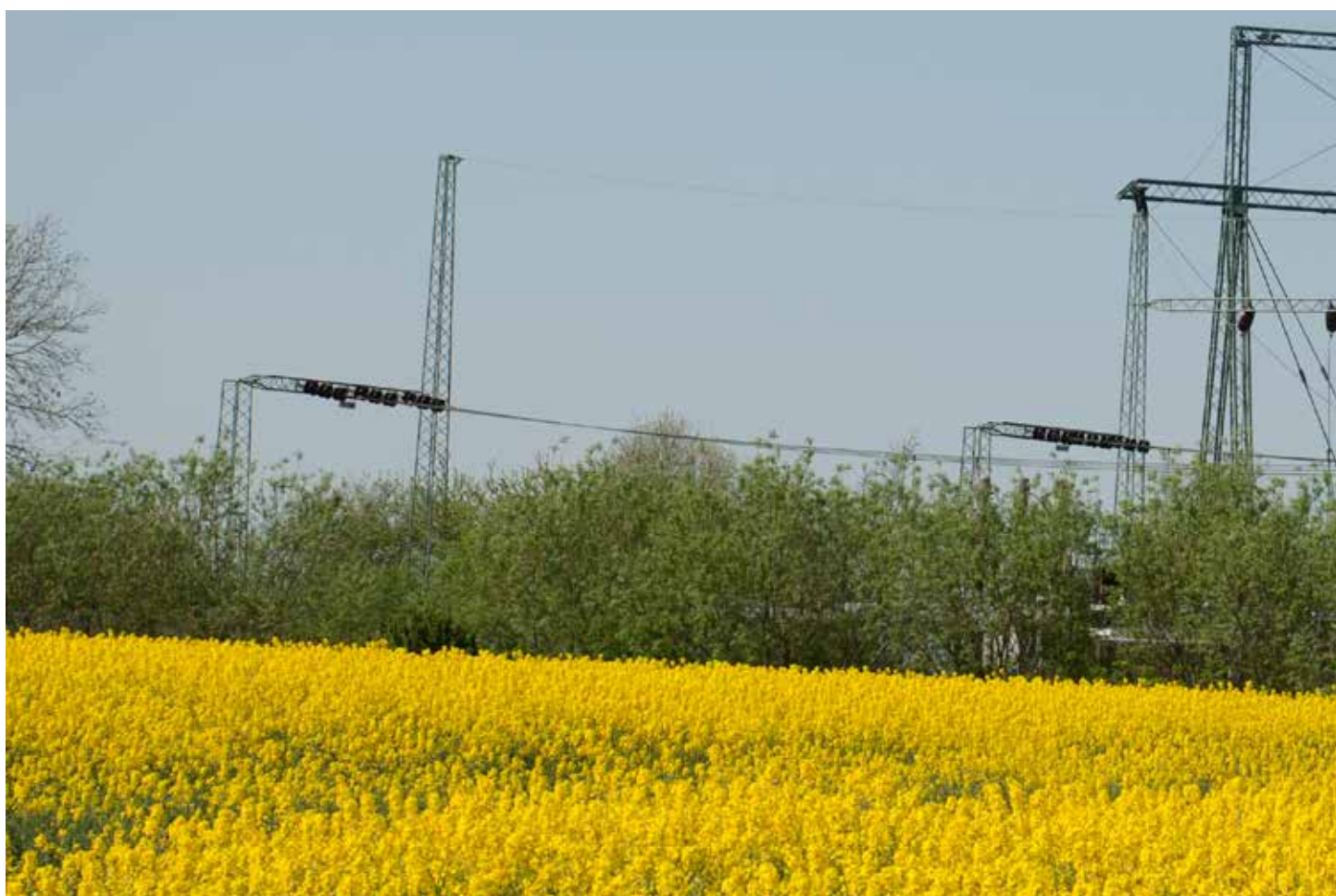
Transformatorstationen ved Margaardvej.
